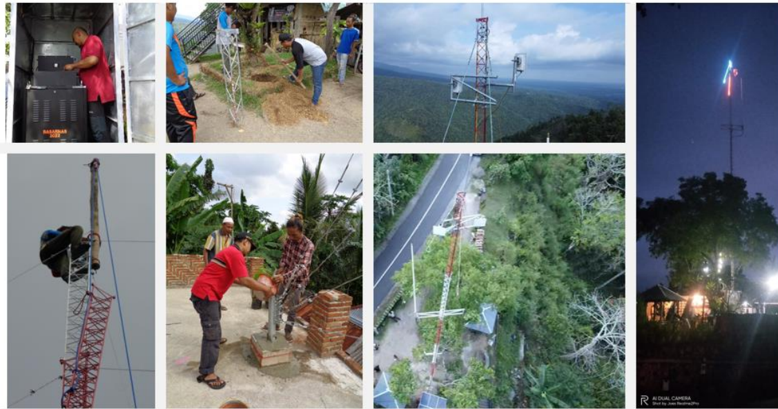
Gambar 23 Tower dan Shelter Repeater Bukit Bakung
