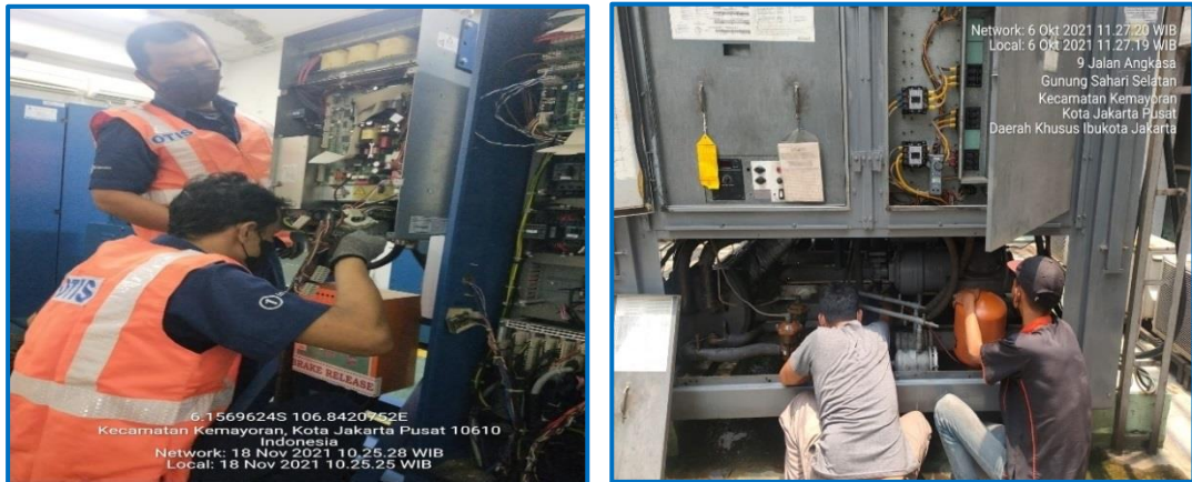
Gambar 5. Pemeliharaan Lift dan AC Sentral gedung Basarnas
