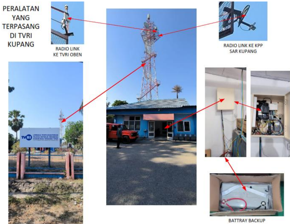
Gambar 23 Instalasi Peralatan Komunikasi Pada Tower TVRI
