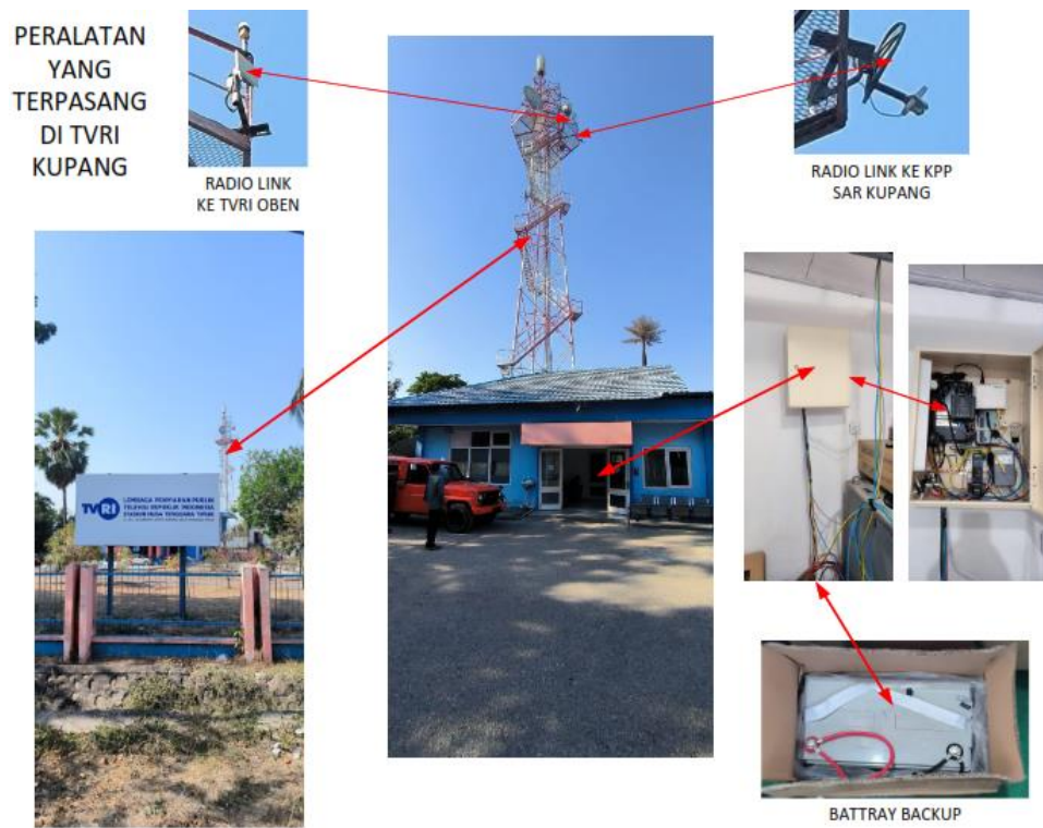
Gambar 8 Instalasi Peralatan Komunikasi Pada Tower TVRI
