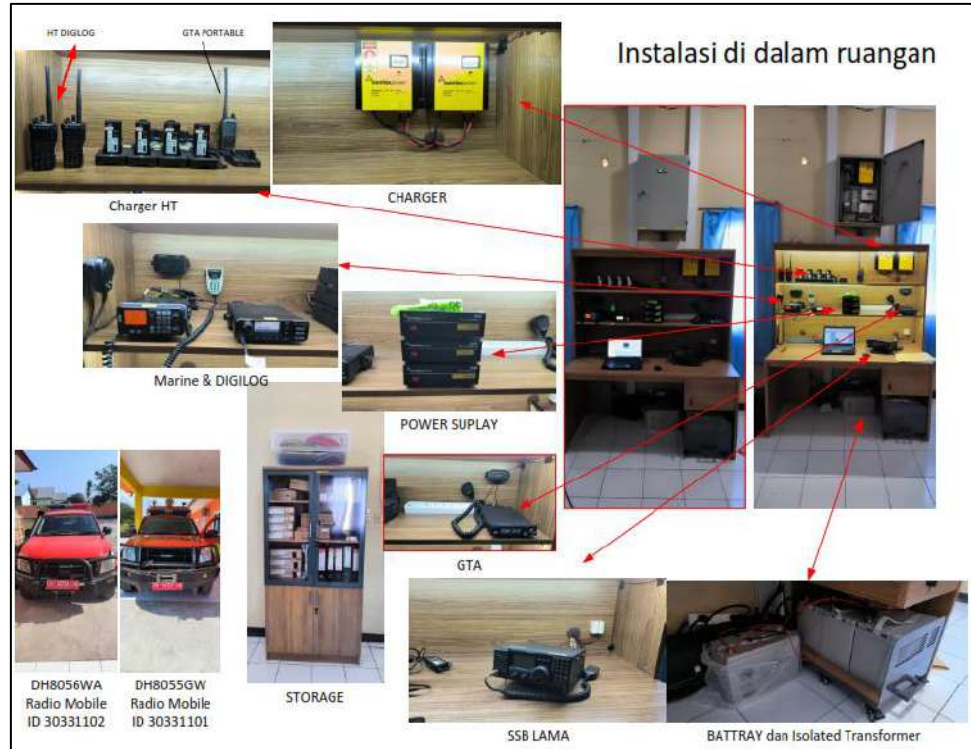
Gambar 10 - Peralatan Base Communication System pada KPP
